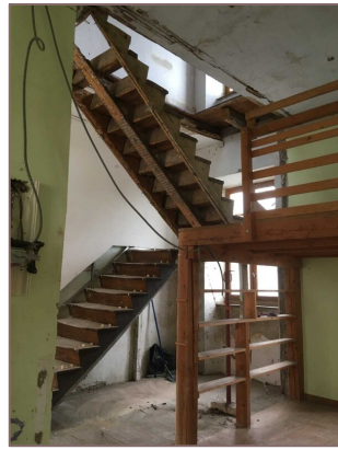
Escalier détruit ayant donné la possibilité ...
